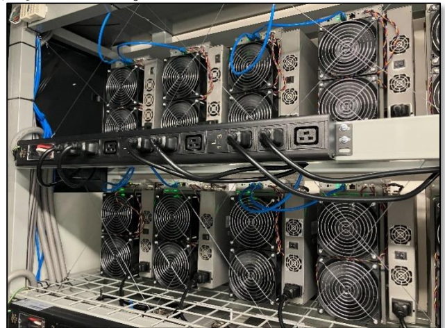
ビットコイン・マイニング装置 (コンテナ内部)
