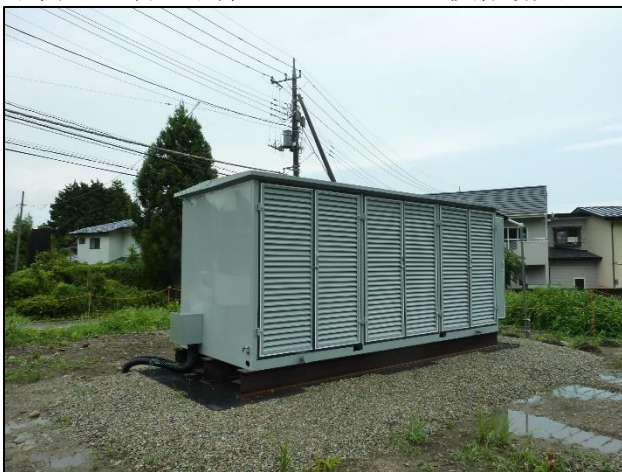
コンテナ型データセンター (外観)
